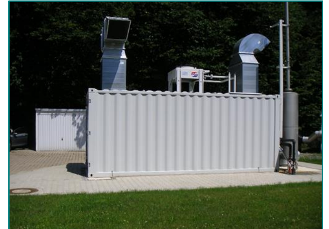
Kläranlage Wittlage, Bad Essen
